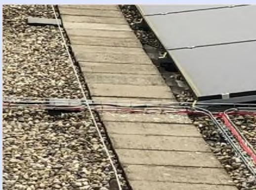
Afbeelding 1: Kabels kruisen het looppad
